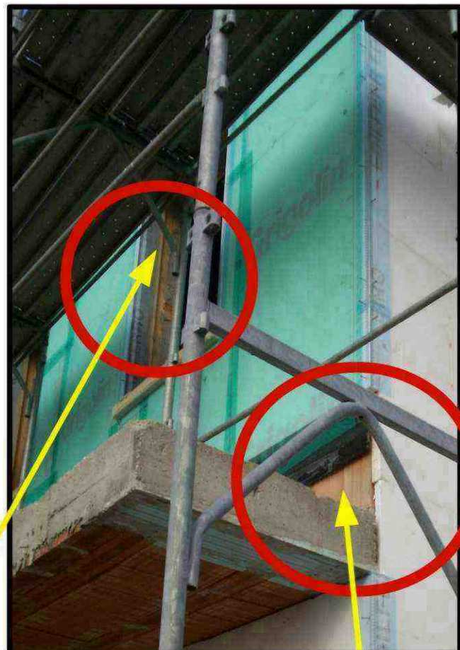
Spallette non isolate, ponti termici enormi
